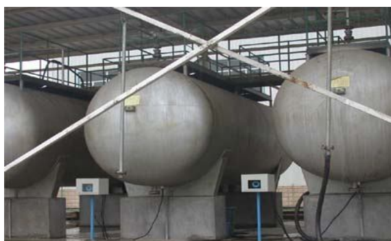
液位计现场安装照片
